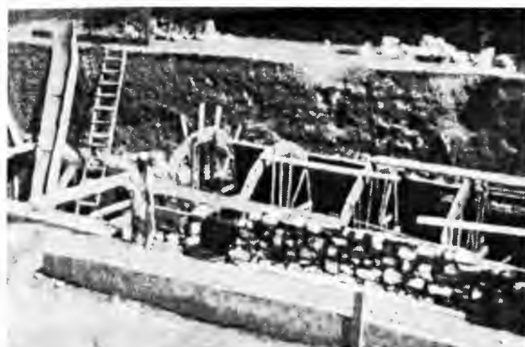
Hôpital saharien à Ksar Es Souk, travaux en cours d'exécution, confection des voûtes.
